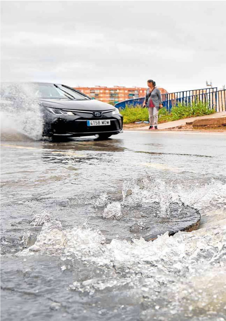
Boca de alcantarillado donde rebosa el agua de lluvia, ayer en la calle Joan Miró en La Torre. IVÁN ARLANDIS
